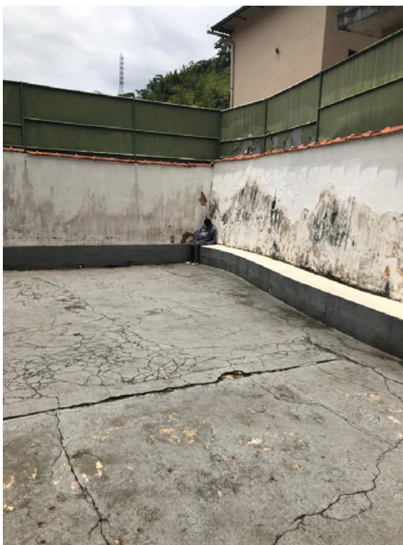
Fotografia 4: Casa de Saúde Santa Mônica, Petrópolis – RJ. Pátio descoberto composto por chão e muretas de concreto para se sentar e, ao fundo, uma pessoa sentada sozinha na quina de altas paredes emboloradas, com cabeça baixa.
